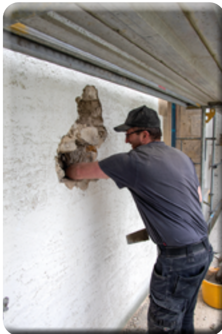
An dieser Stelle ist das Mauerwerk 2-schalig mit einem Hohlraum dazwischen.
